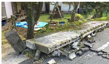
地震で倒れた門柱と塀(筆者自宅)
