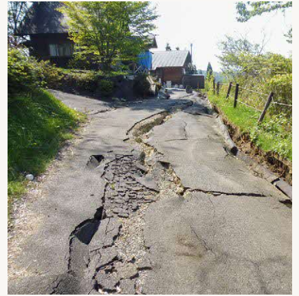
▲熊本地震による被害の様子（南小国町内）
