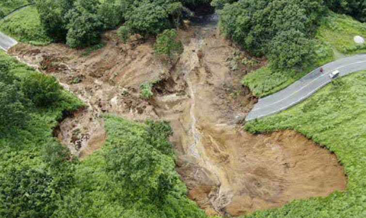
令和2年7月豪雨 マゼノミステリーロード土砂崩れ
