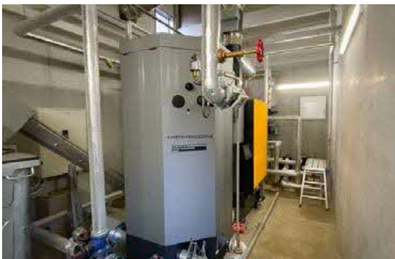
▲木質チップボイラー
