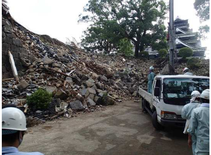
図 平成 28 年熊本地震による被害 熊本城、頼当御門周辺 石材撤去の様子
