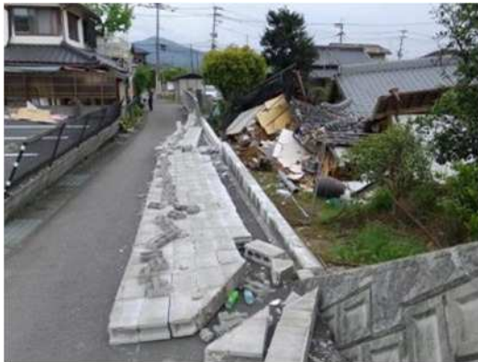
図 ブロック塀の倒壊
