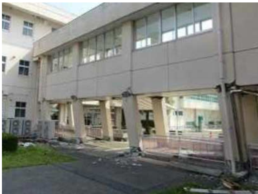
図 渡り廊下の倒壊（校舎）
