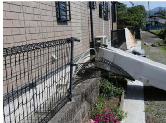
図 給湯施設の転倒
