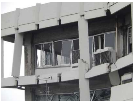
図 庁舎棟の局部崩壊
