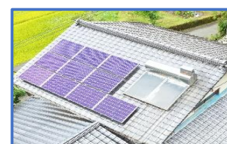
太陽光発電設備
