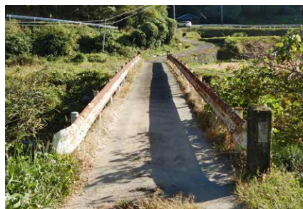
老朽化が進む橋
