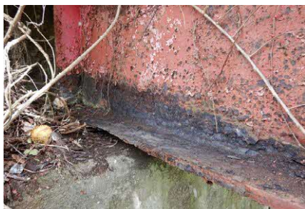
腐食した橋桁
