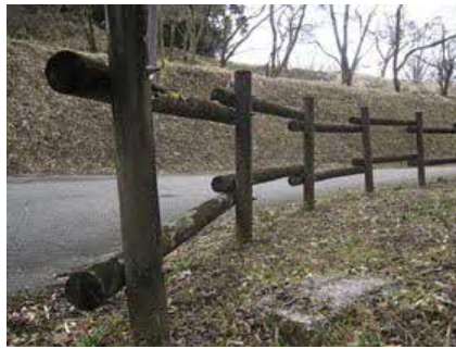
老朽化している木柵
