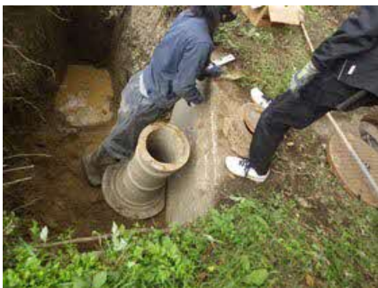
田の原の漏水箇所
