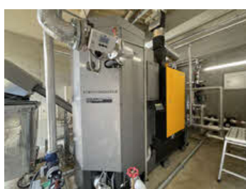
操作はタッチパネルなので 重油ボイラーに比べ簡単に
