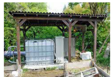
湯田地区(北二又)に設置されたマイクロ水力発電設備
